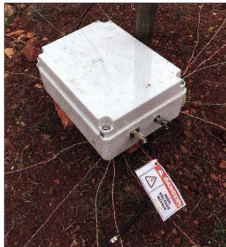
Antennenkoppler für unsere 160-m-Vertikalantenne mit angeschlossenem Radial-System
