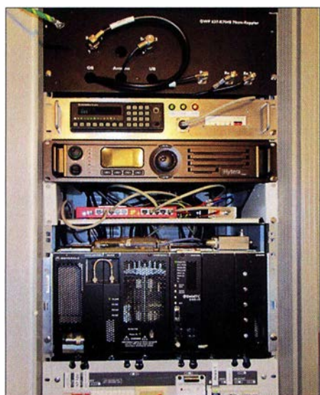
Relaistechnik von DB0WOL; man sieht u. a. den Hytera-Repeater, die Weiche und unten eine Motorola-Quantar-Anlage für 70-cm-FM-Betrieb.
