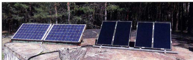
Solarpanels für die Stromversorgung von DB0WOL
